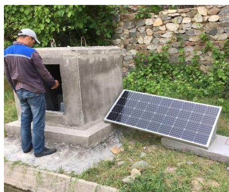
Рис. 5. Установленное оборудование на грунте.
